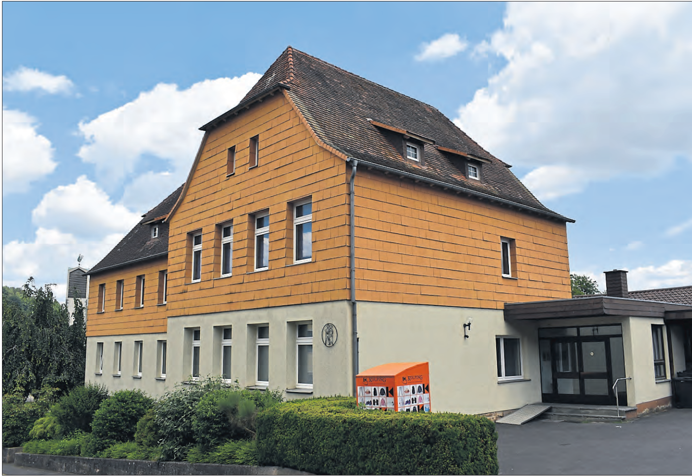
Die Alte Schule in Rothemann ist sanierungsbedürftig.
